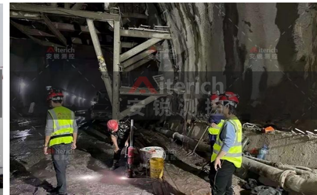
玉墨铁路安定隧道永久性监测项目
