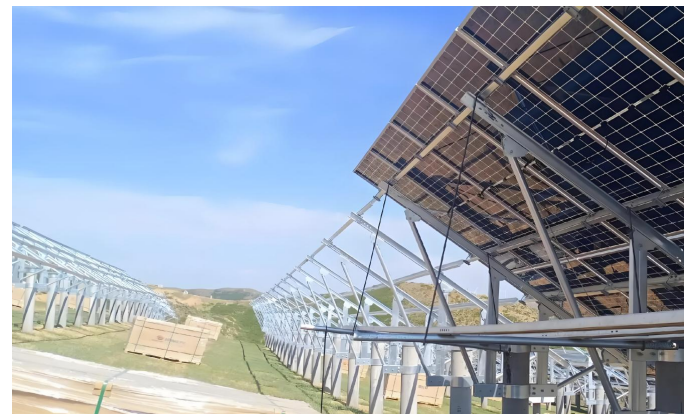
光伏电站拉索
