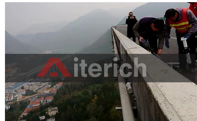
贵州虎跳河大桥动态挠度监测项目
