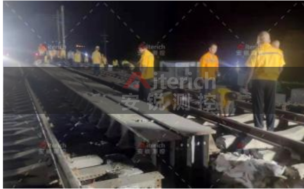
三亚公路下穿高铁涵洞实时监测项目
