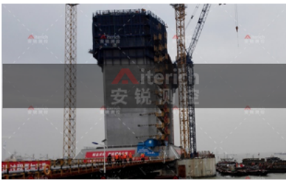
上海沪通大桥液压爬模监测项目
