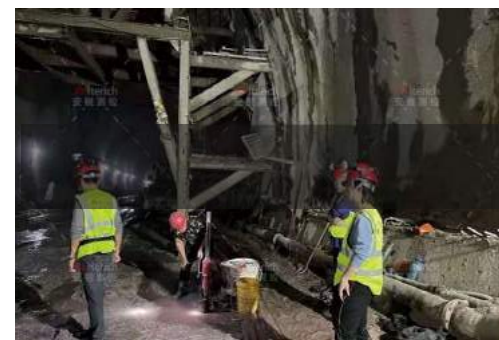
玉墨铁路安定隧道永久性监测项目
