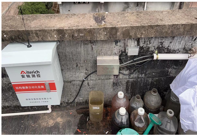
浙江绿建某 危房 沉降监测
