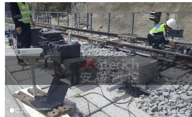
拉萨道岔二维码位移监测项目
