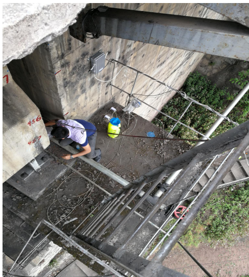
松河 四线桥 沉降监测
