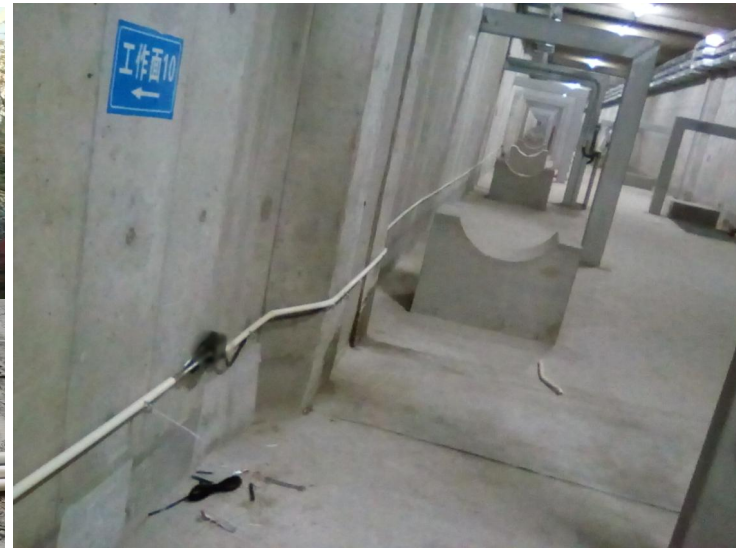
柳州 管廊 沉降监测
