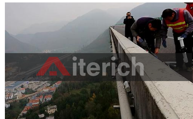
贵州虎跳河大桥动态挠度监测项目
